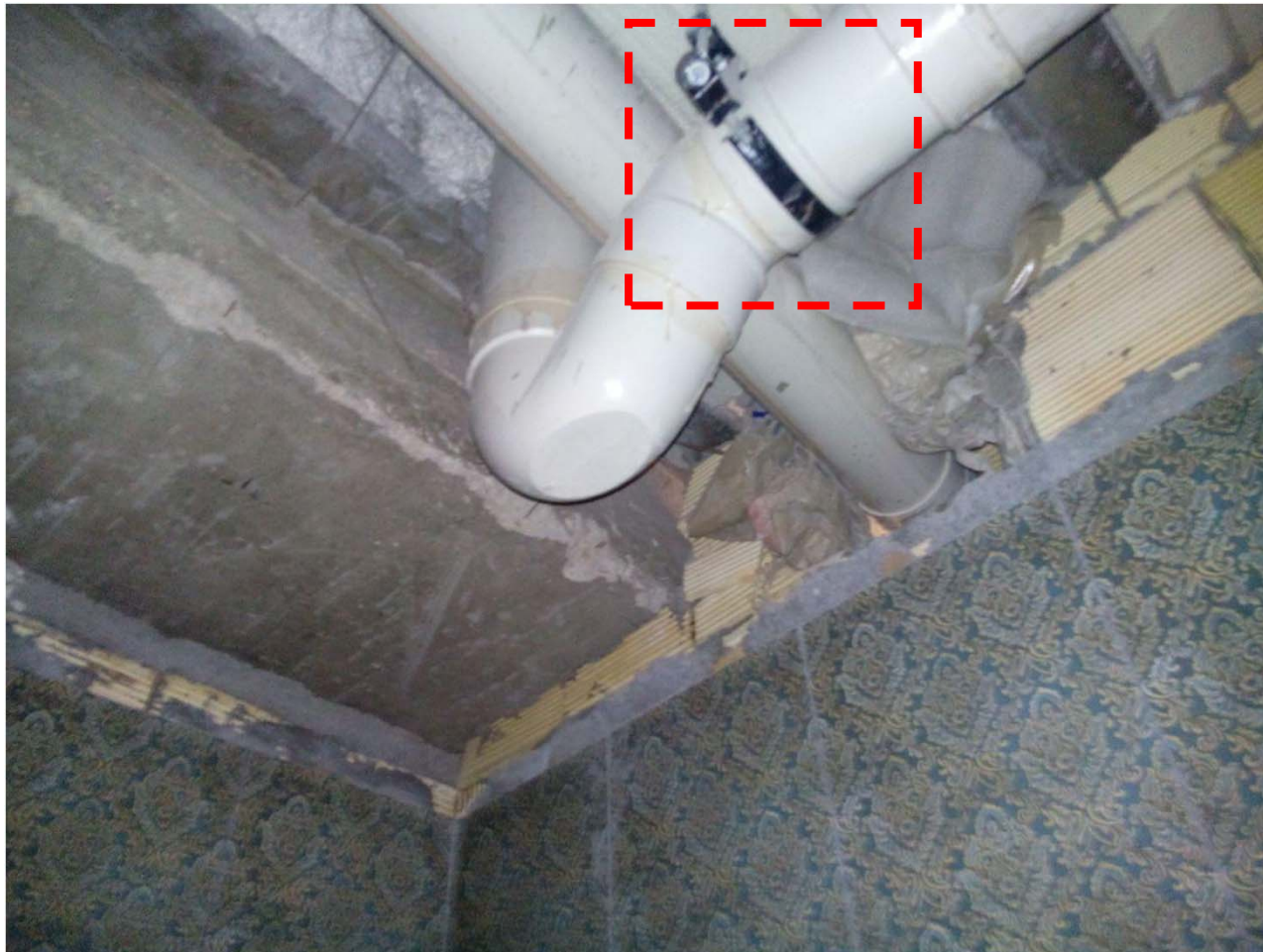
شکل ۳۵- مهاربندی نامناسب سیفون
