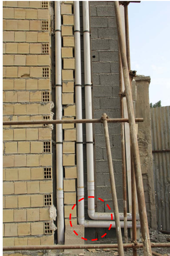
شکل ۲۶- اجرای نادرست رایزر آب باران
