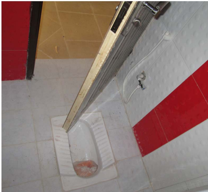
شکل ۲۳- محل نامناسب اجرای سرویس بهداشتی
