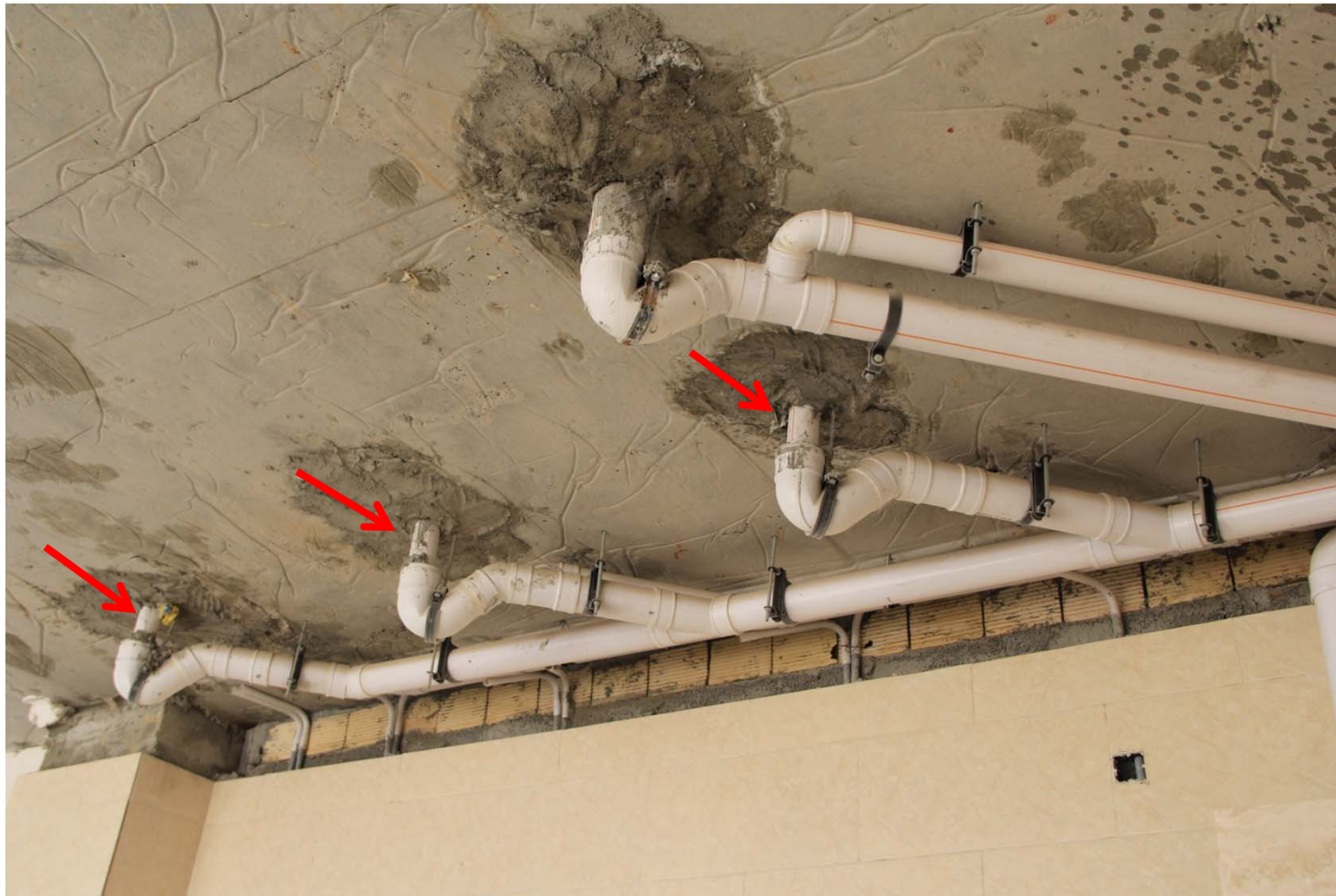
شکل ۲۸- اجرای نادرست از تبدیل ۲ به ۳ و عدم نصب دریچه بازدید در محل افقی خط
