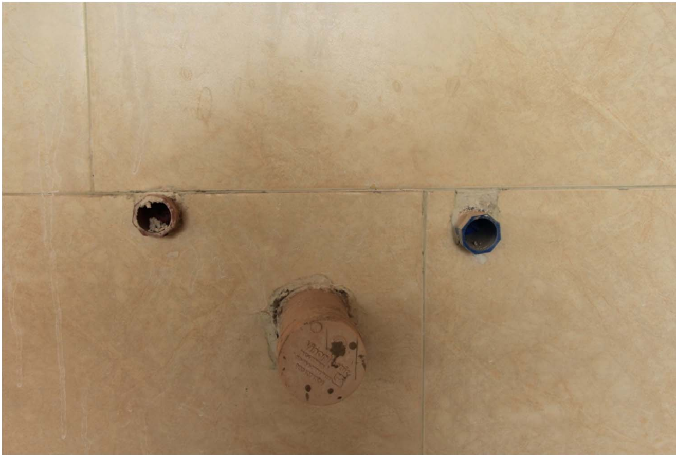
شکل ۳۰- عدم استفاده از شابلون در اجرای انشعاب آب مصرفی
