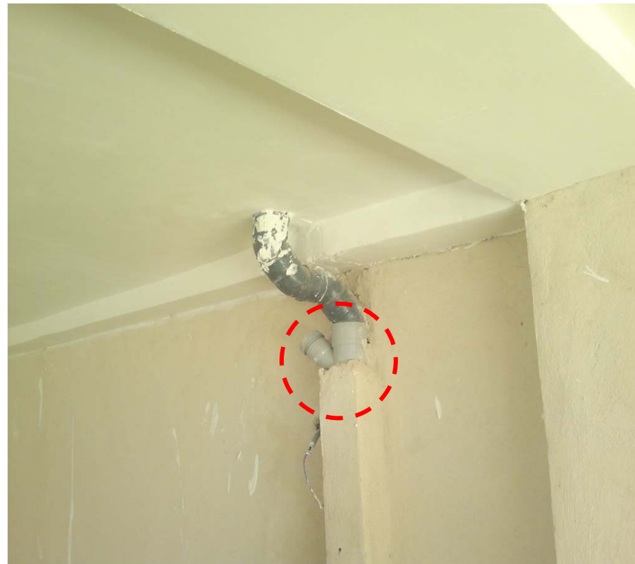
شکل ۱۸- محل نامناسب نصب دریچه بازدید
