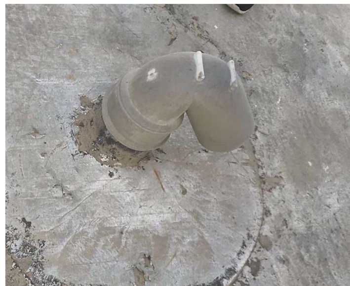
شکل ۳۶- اجرای نامناسب خط هواکش و استفاده از کلاهک نامناسب بر روی رایزر هواکش در پشت بام
