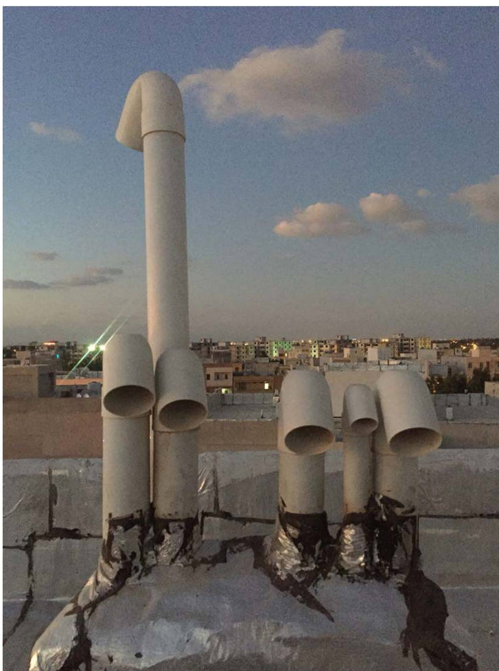
شکل ۳۷- استفاده از کلاهک نامناسب بر روی رایزر هواکش در پشت بام
