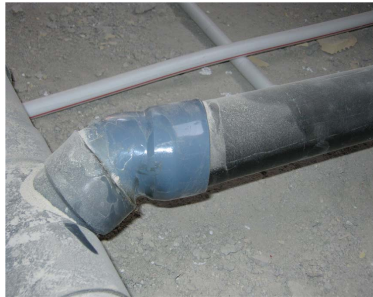
شکل ۱۲- گرم کردن نامناسب اتصالات
