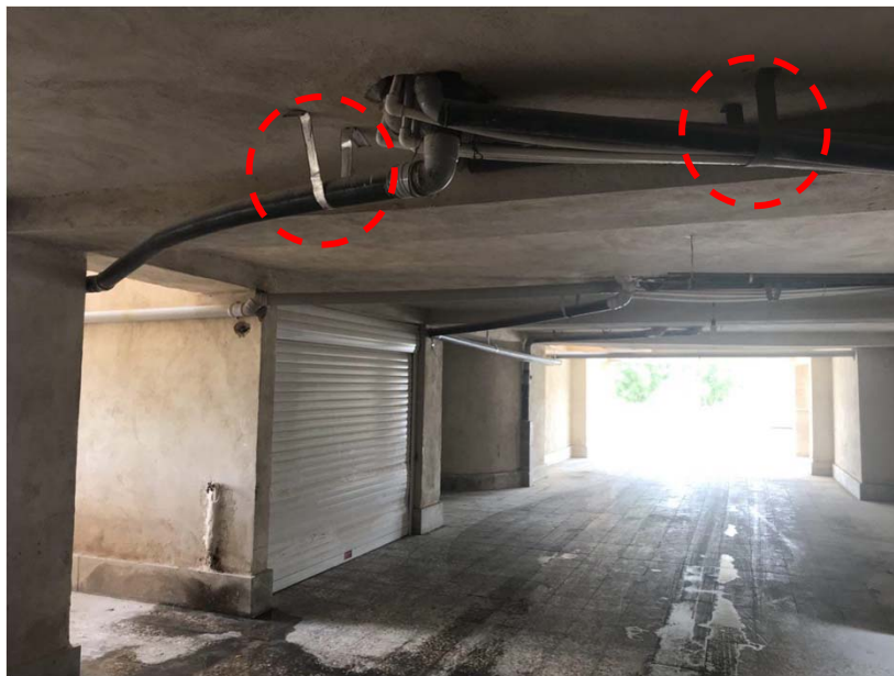
شکل ۸- استفاده از سایپورت های نامناسب در خطوط فاضلاب
