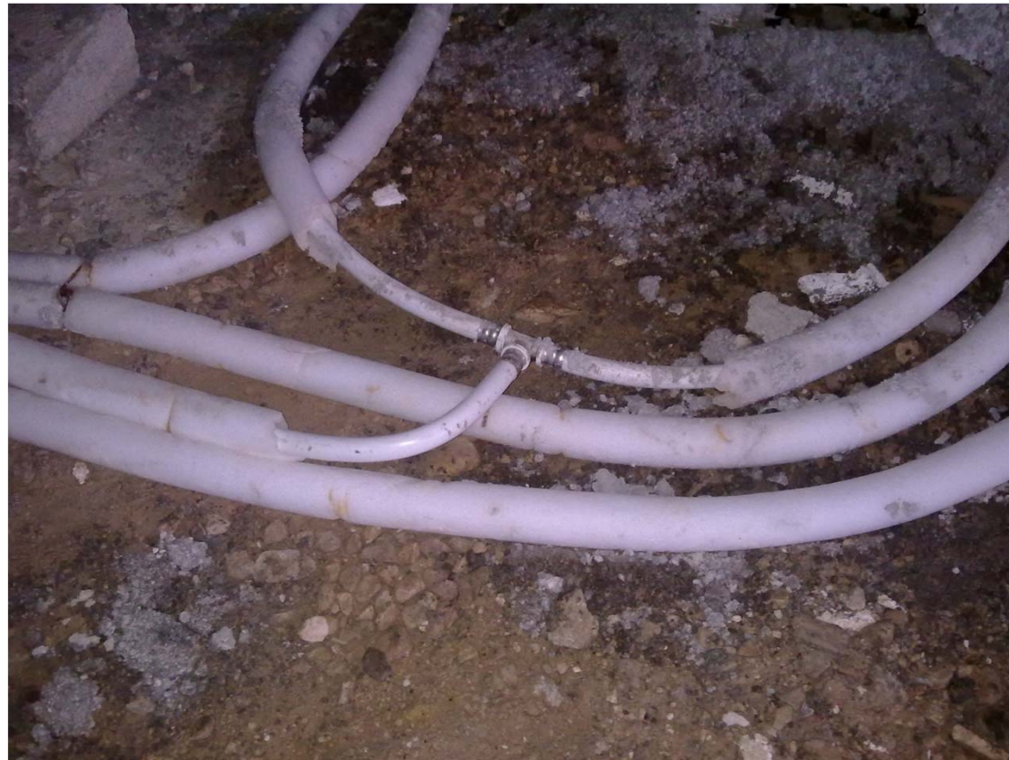
شکل ۳- عدم عایق رطوبتی اتصالات
